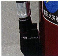
× 消火薬剤の漏れ
